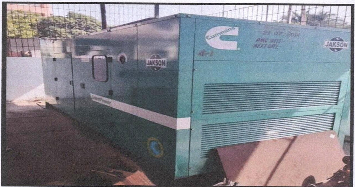
Fig. 2.6- 250 kVA DG Set
